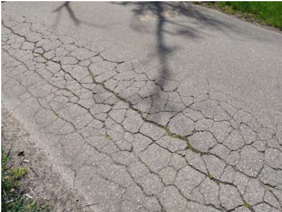
Ubytki przed modernizacją drogi
